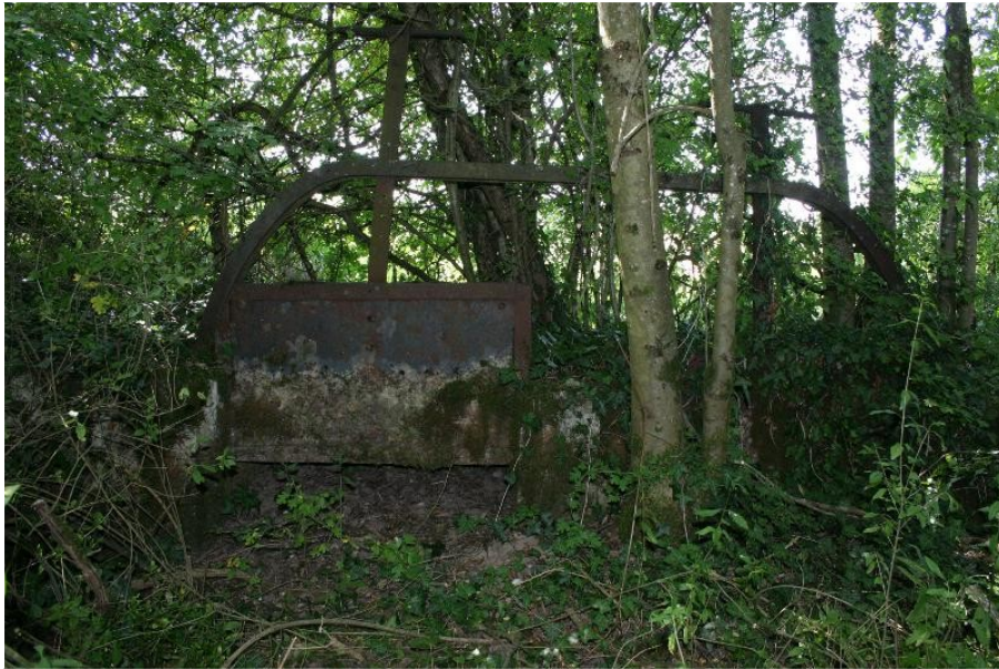
Vanne d'irrigation à l'amont du barrage des Vannes Rouges
